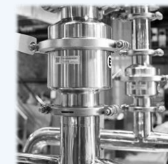
プレファブ配管のEP
